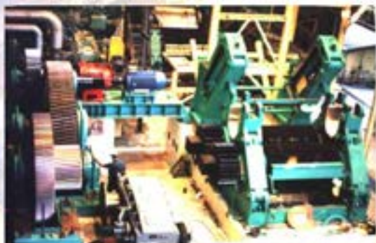
Instalación del molino de seis mazas - Australia
