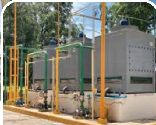
Ingenio Adolfo López Mateos, Tuxtepec, Oax. Torres paquete para enfriamiento de condensados
